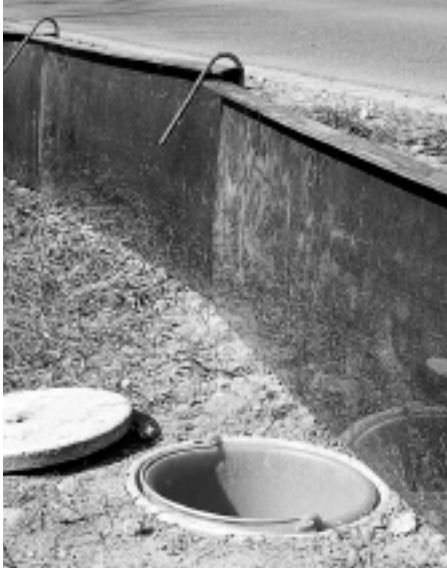
Auch einfache, kostengünstige Konstruktionen leisten beim Amphibienschutz an Strassen gute Dienste (Foto: Ch. Bühler).
